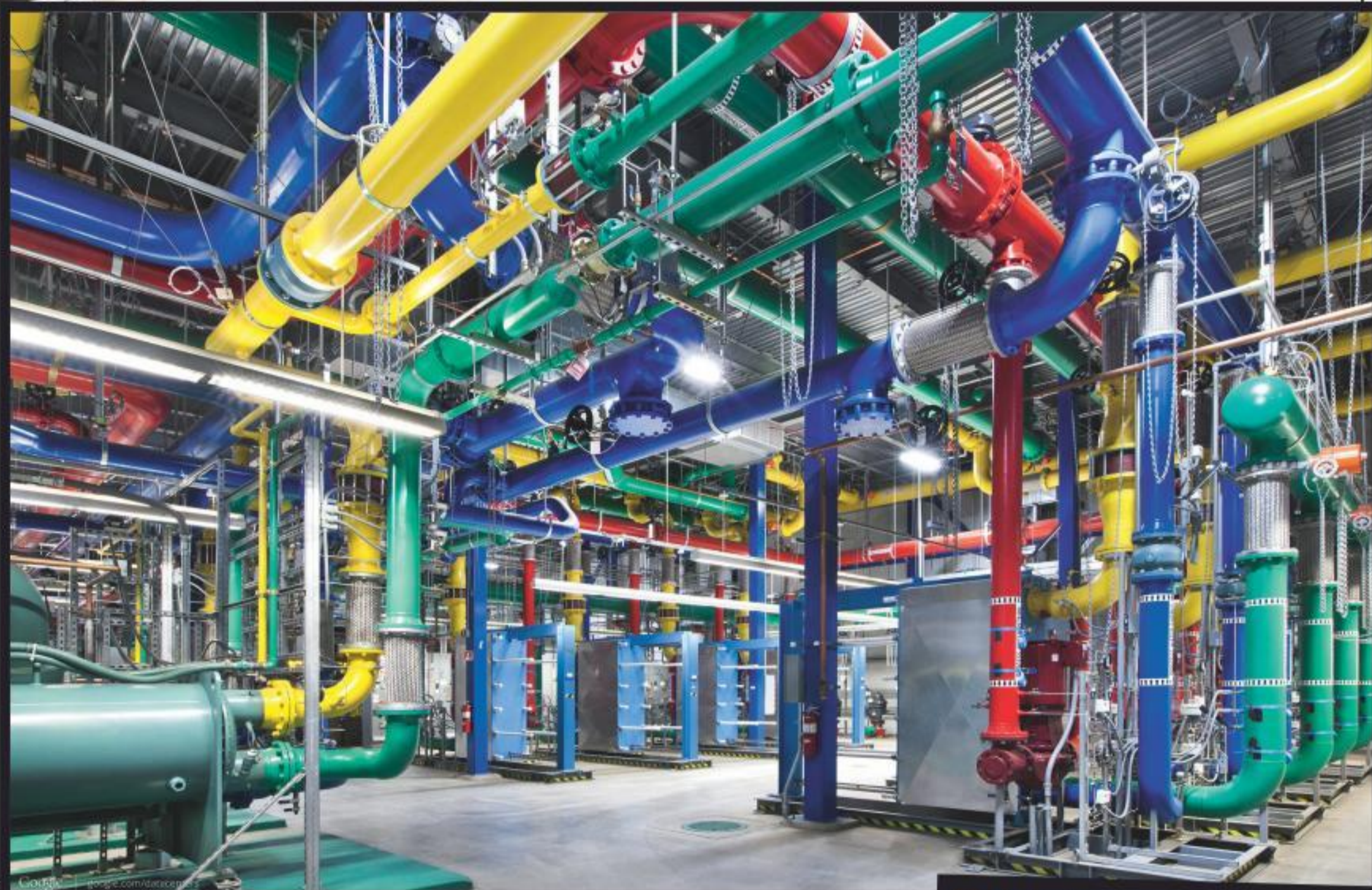
А так выглядит «кровеносная система» нейронной сети. Мощные охлаждающие установки создают серверам комфортный микроклимат.
