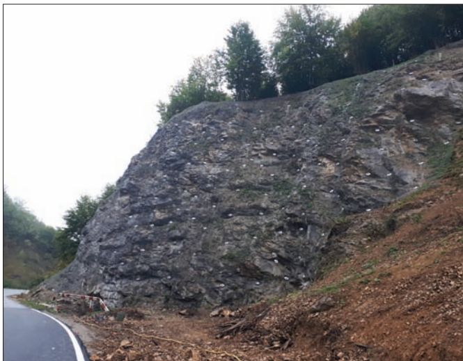
Foto 3: Versantul stânga stabilizat și protejat activ cu sistemul activ Tecco® G65/3 tip plasă ancorată de înaltă performanță
