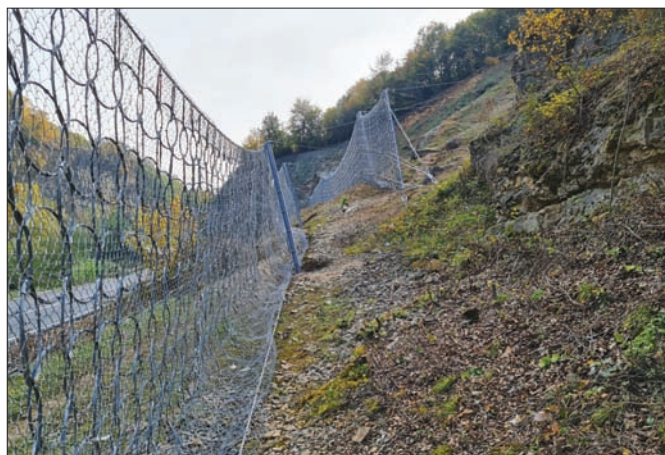
Foto 6: Vedere laterală cu suprapunerea sistemelor RXE-500-LA și RXE-1000
