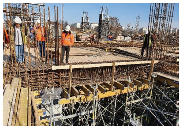
Fig. 14: Execuție cofraj (eșafodaj) și armare grindă post-comprimată pe zona sălii de sport – Peluza Nord
