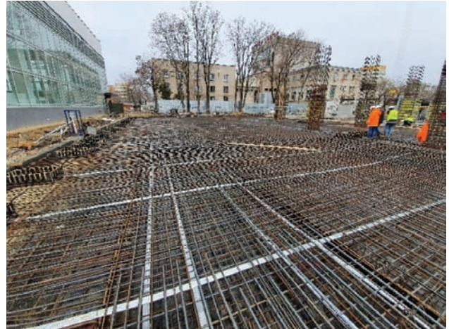
Fig. 16: Execuție armătură pasivă și dispunere toroane în planșeu post-comprimat peste subsol Peluza Sud
