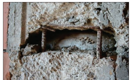
Fig. 3: Stâlpișor executat cu defecte
