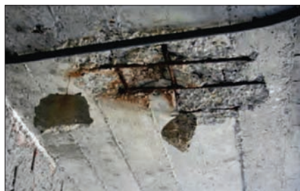
Fig. 2: Suprafață degradată din beton
