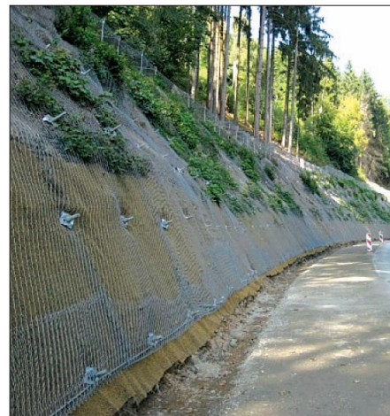
Foto 2: Stabilizare de versant cu plasă din oțel de înaltă rezistență și rețea antierozională
