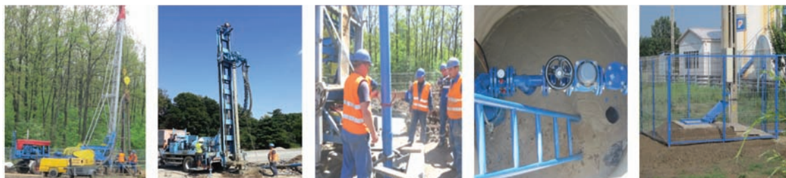
Foraje de explorare hidrogeologică și monitorizare; foraje de alimentare cu apă, inclusiv cămine și instalații hidraulice
