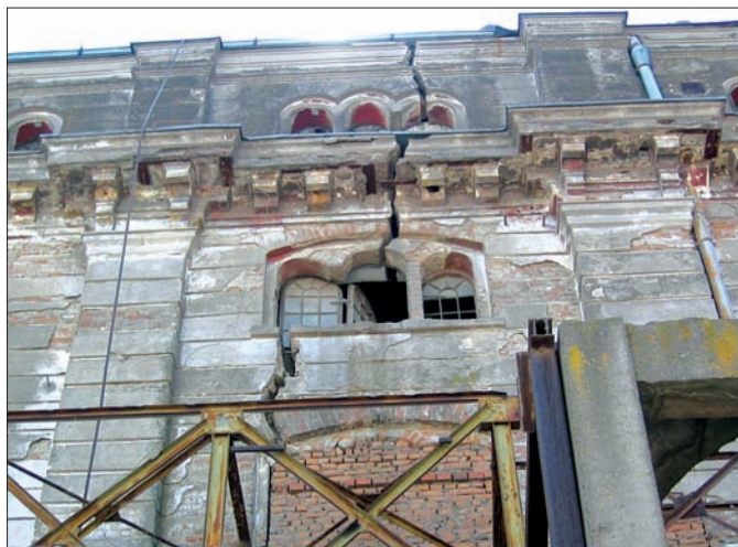
Degradări ale silozului din portul Brăila generate de putrezirea piloților din stejar (anul imaginii: 2005)
