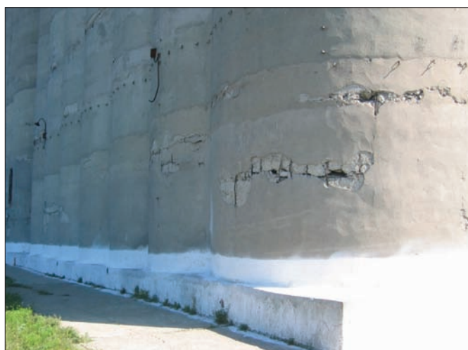
Defecte de execuție observate la exteriorul celulelor (anul imagine: 2008)
