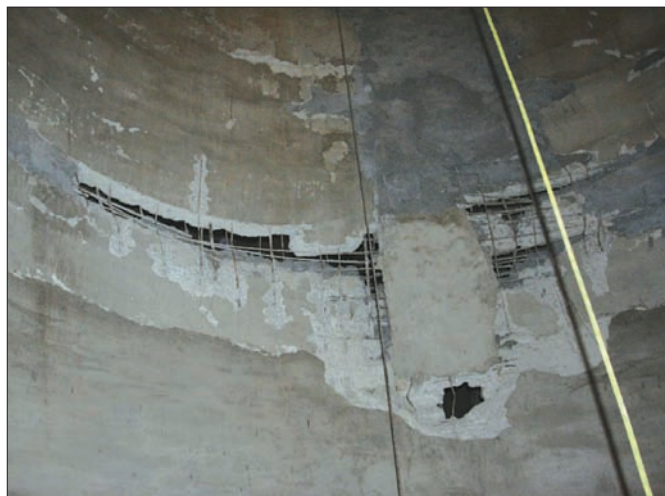
Defecte de execuție observate la interiorul celulelor (anul imaginii: 2010)
