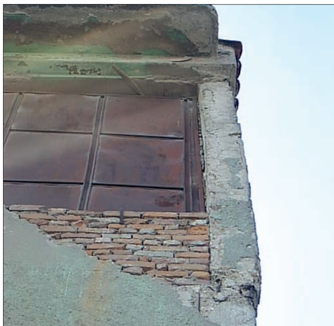
Degradări seismice la nivelul galeriei superioare a unui siloz de tip PCA (anul imaginii: 2003)
