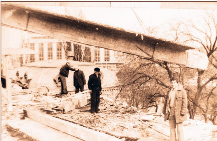
Imagine din timpul extragerii unei grinzi de beton armat de 8,0 m lungime de la Spitalul Brâncovenesc
