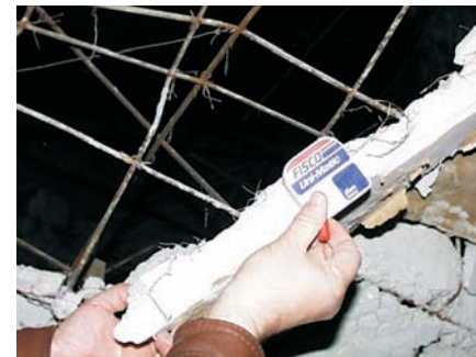
Foto 9, 10: Unele aspecte de neconformitate: grosimea necorespunzătoare a tencuiei
