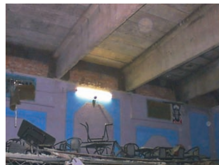
Foto 2: Structura nu este afectată de prăbușirea tavanului
