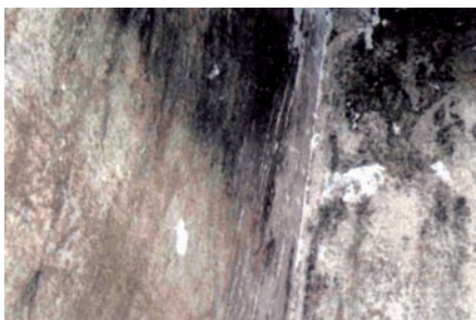
Foto 2: Stricăciuni provocate de apă
