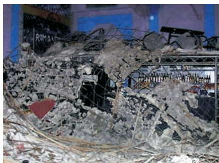
Foto 5: S-a produs colapsul total al plafonului suspendat cu rol fonoabsorbant, decorativ și de mascare a structurii de rezistență, tavan realizat la sala de proiecție, având dimensiunile de 18 m x 14 m și suprafața de 252 m 2 . Plafonul și-a pierdut stabilitatea și s-a prăbușit în timpul programului de discotecă. Durata evenimentului, apreciată de utilizator, a fost de 2-3 min.
