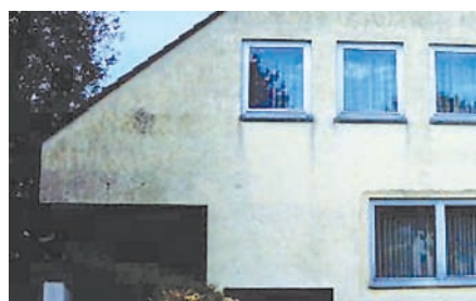
Foto 4: Exterior cu mucegai
