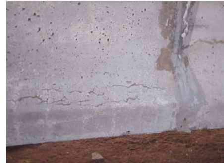
Fig. 1: Fisuri în bolțarii prefabricați, tipice coroziunii
