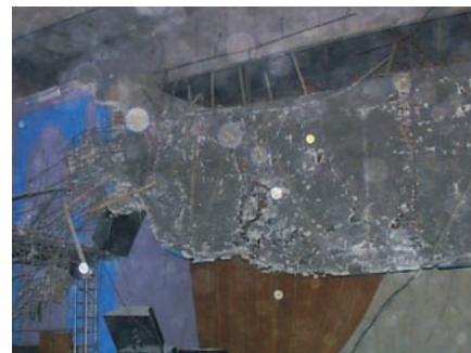
Foto 7: Detalii din zona scenei. Tavanul a rămas suspendat de ancorajele suplimentare metalice, executate numai în această zonă
