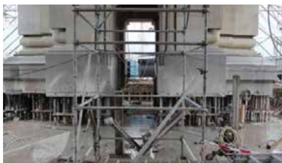
Fig. 19, 20 Sus: decuplare suprastructură de fundații, introducerea barelor de armătură pentru turnarea cadrului purtător superior | Jos: Arcul de Triumf decuplat de fundații (Credo Design, 2017)
