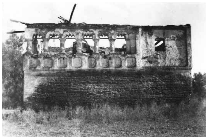
Fig. 41 Cula Cuțui, Broșteni, înainte de restaurare, 1962 (Arhiva D.M.I.)
