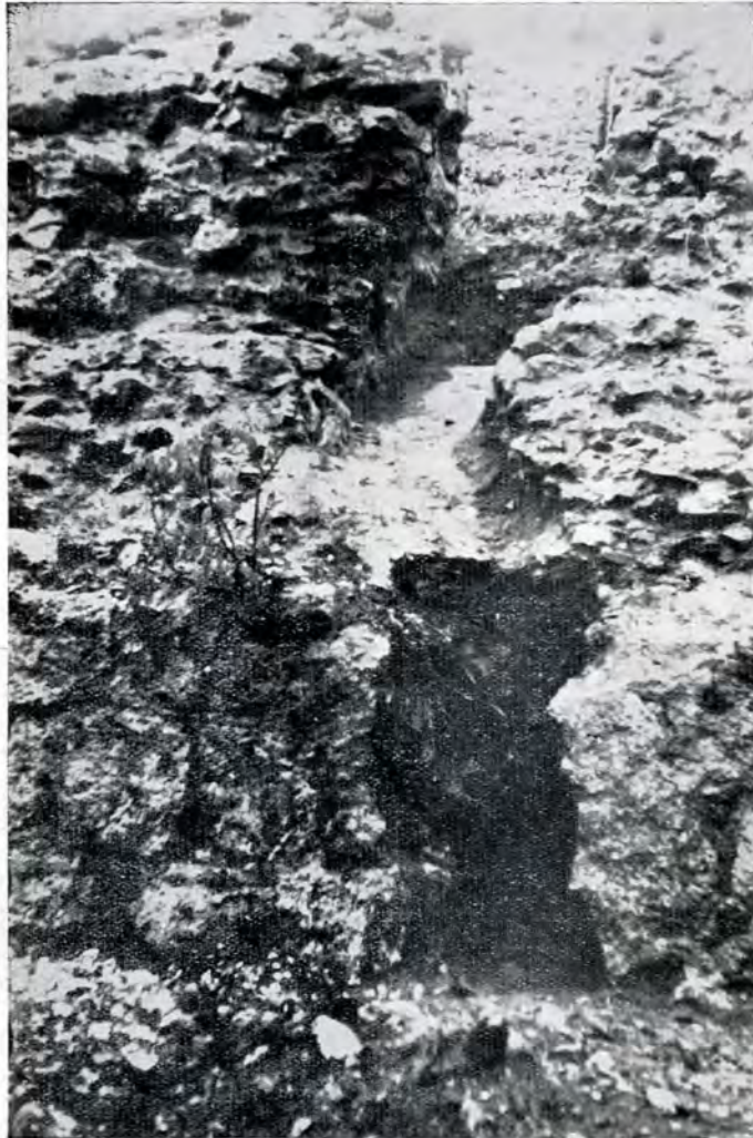
Fig. 3. — Spărtură in zidul din fig. 1-2, văzută din exterior.
