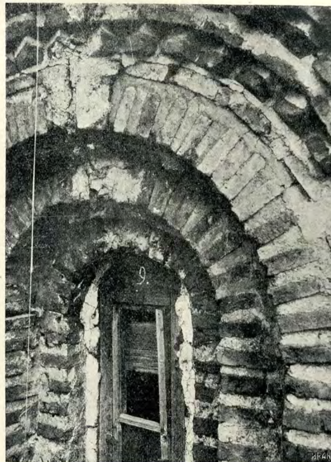
Fig. 101. Degradări în fereastra de sud a turlei.
