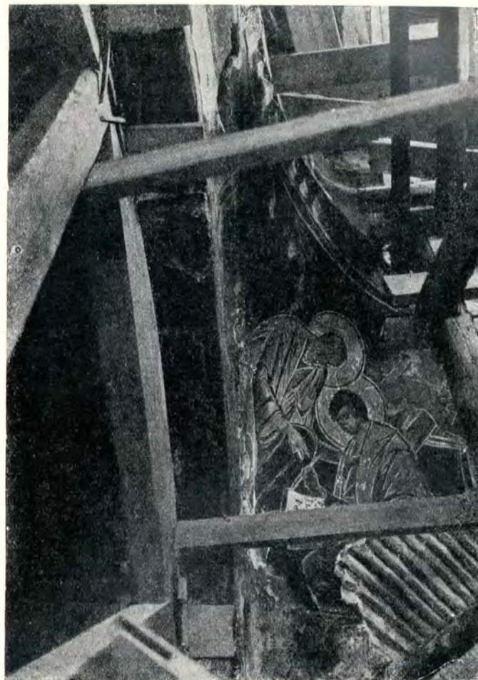
Fig. 106. Degradări interioare pe intradosul arcului de est.
