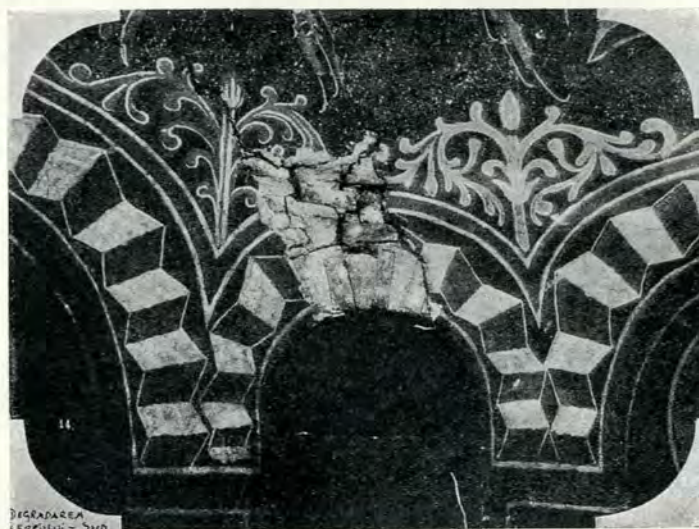
Fig. 107 Degradări interioare în nișele turlei, dintre ferestre.
