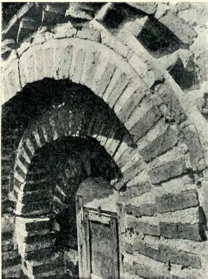
Fig. 100. Degradări în fereastra de vest a turlei.
