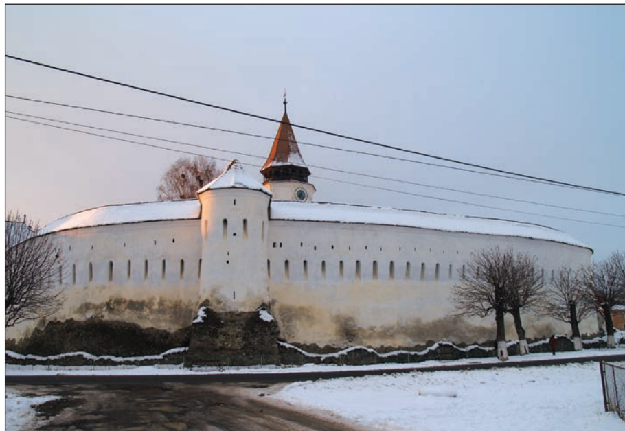
Fig. 5 - Prejmer. Perspectivă asupra bisericii fortificate dinspre sud-est; umiditate excesivă în ziduri / Prejmer. South- East perspective to the fortified church; humidity in excess into the walls
