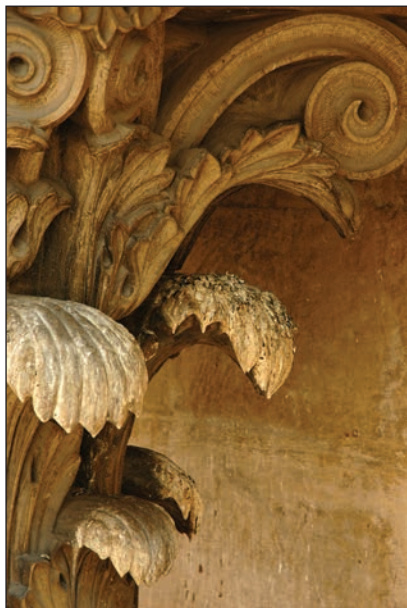
Fig. 9 - Suprafețe de molon slab degradate prin depuneri de praf și excremente de păsări. / Weak degraded areas by dust and bird droppings.
