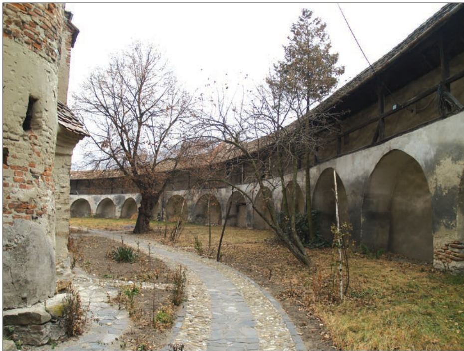
Fig. 4 - Valea Viilor. Biserica fortificată, zidul de incintă cu drum de strajă și sistemul de drenaj refăcut în 2011 / Valea Viilor. The fortified church, the enclosure wall with the watch road and the drainage system, restored in 2011
