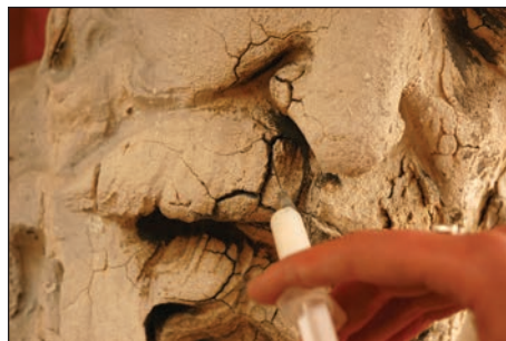
Fig. 20 - Zone de calcar friabil și fisurat care au necesitat consolidarea suportului, înainte de colmatarea fisurilor, prin impregnarea soluției consolidante: (a) prin pulverizare; (b) prin pensulare; (c) prin injectarea consolidantului în fisurile din rocă, fațada Lipscani / Brittle and cracked limestone areas that required consolidation of the support, before clogging the cracks, by impregnating of the consolidated solution: (a) by spraying, (b) by brushing, (c) by injection of the consolidated solution into the rock fissures, the Lipscani facade.
