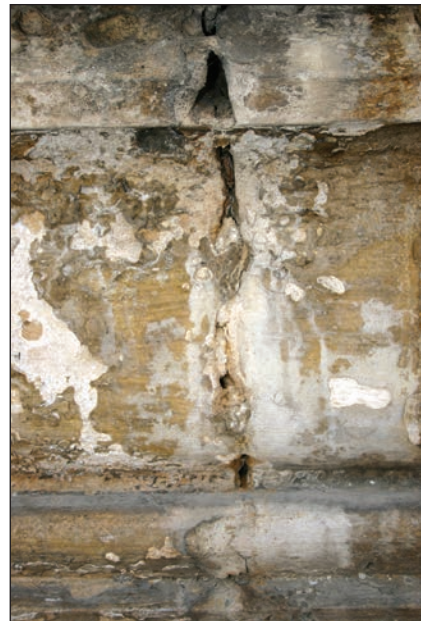
Fig. 13 - Eflorescențele de săruri dezvoltate în zonele de intrados ale moloanelor din zona acoperișului sau la rosturile dintre moloane. / Salts efflorescence developed under the blocks in the roof area or at the joints between the blocks.
