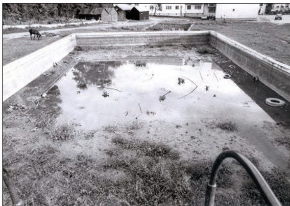
Fig. 16 Fostul bazin de înot / L'ancienne piscine communale
