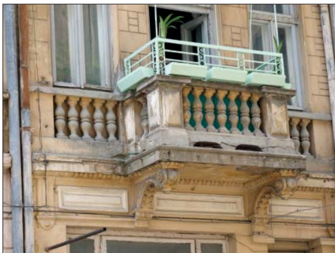
Fig. 5 - Reparații făcute de proprietar
