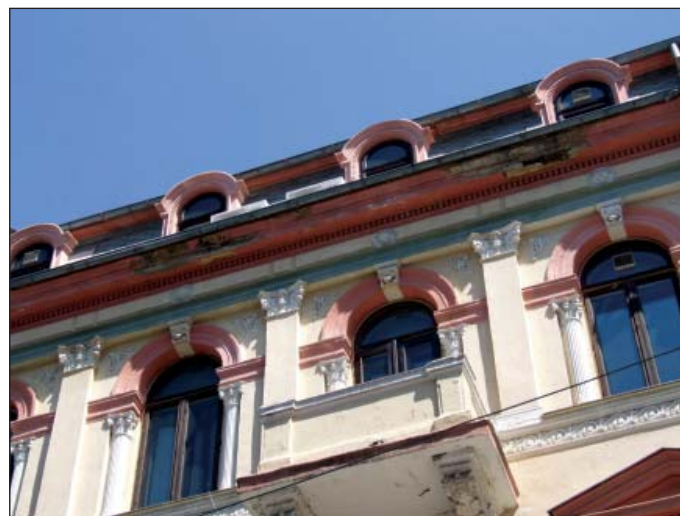
Fig. 10 - ...dar degradările au și apărut,
