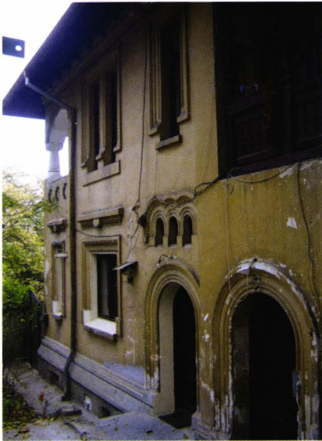
8. Vila Aleea Dealul Mitropoliei nr.17, arh. Gh. Simotta - Detaliu fațadă Aleea Dealul Mitropoliei, nr. 17
