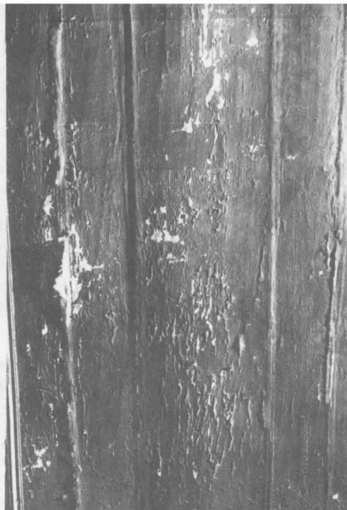
Fig. 6. Naos, peretele de sud: detaliu, înainte de restaurare, cu degradări pe traiectul fibrelor lemnoase, prin ridicături cu muchii și dezlipirea fișiiilor de pînză puse la îmbinarea scîndurilor.
