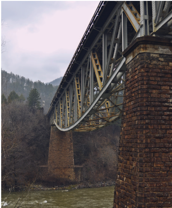
Fig. 11: În Defileul Jiului, suspendată la înălțimi de 20 - 30 m, calea ferată traversează râul pe poduri metalice din grinzi cu zăbrele și oferă privirii peisaje legendare (foto: T. Feczko).
