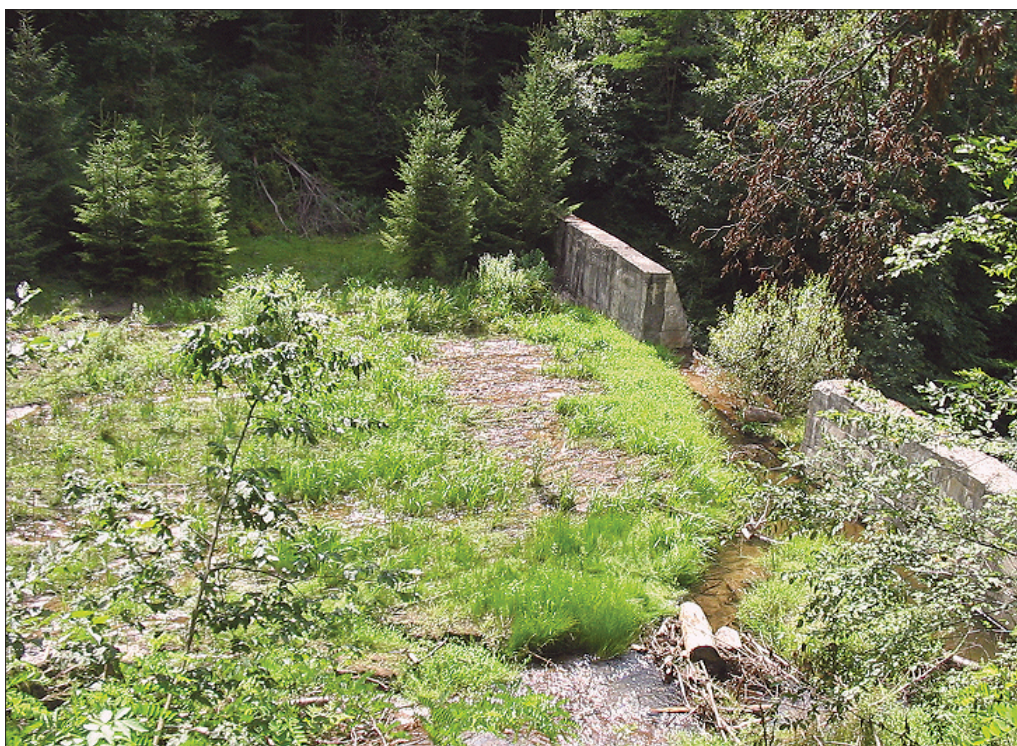
Fig. 2. Pârâul Păltinița: consolidare prin aterisare la barajul 10P4.0) (Foto Florin Lupașcu, 2006)
