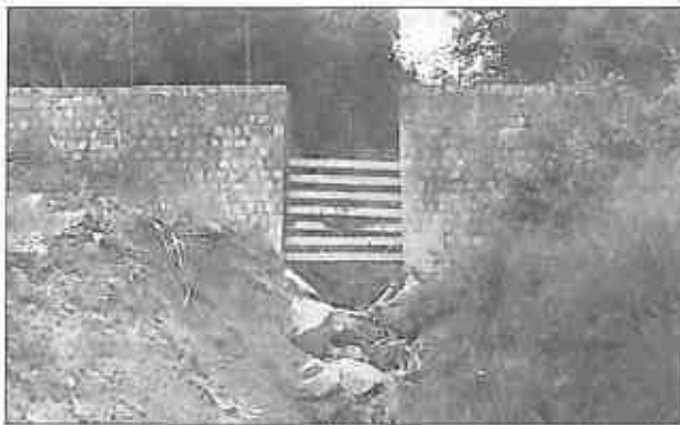
Foto 6. Barajul filtrant 5M4,0 pe Valea Bărdălegi–Buzău, scos din funcțiune în urma blocării deschiderilor, în iulie 1991 (Gaspar, 1992).
