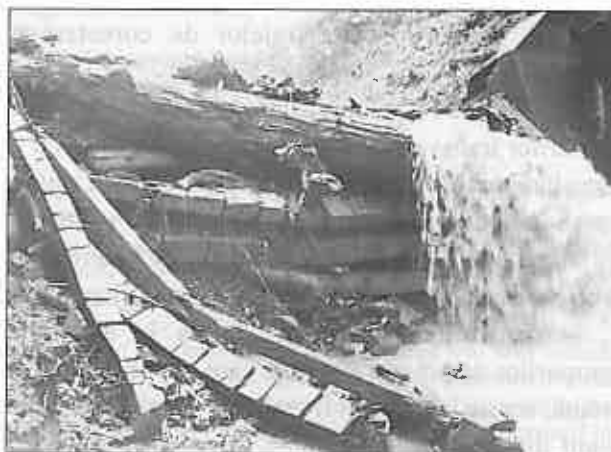
Foto 11. Barajul greblă 4B3,0 de pe Valea Tirului (B.h.Valea Rea-Sinaia), din foto 10, distrus de șocul buștenilor, la viitura din 1972 (Gaspar, 1972).
