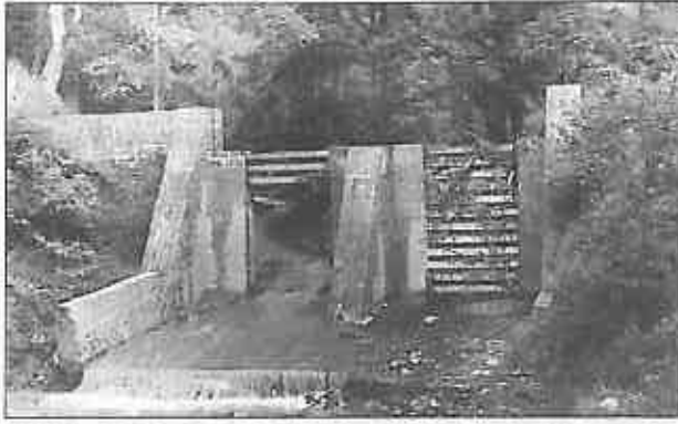
Foto 5. Barajul filtrant din contraforți și grinzi de beton armat 9M5,0 (Valea Giurca Mare – Buzău), scos din funcțiune în urma blocării deschiderilor (Gaspar, iulie 1992).
