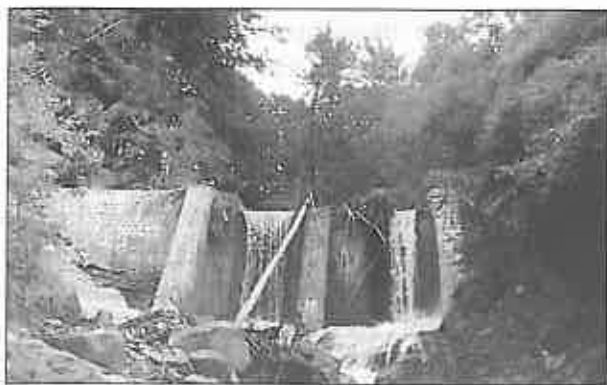
Foto 2. Blocarea parțială a unui deversor cu materiale lemnoase la viiturile din anul 1991. Valea Giurca Mare-Buzău, barajul 4M6,0 (Gaspar, iulie 1991).
