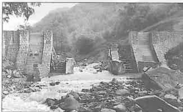
Foto 4. Barajul filtrant din contraforți și grinzi de beton armat 9M5,0 ( Valea Păltiniș-Bâsca, Râul Buzău), distrus de viiturile din iulie 1991 (Gaspar, iulie 1992).
