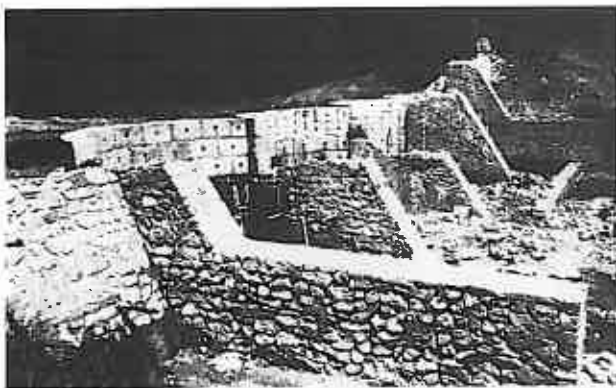
f) - Barajul (15 MB4) din "blocuri de beton simplu prefabricate pe contraforți din zidărie" avariat (partea superioară a contraforților deversanți, aripa din dreapta și contrabarajul rupte) la viitura foarte puternică din anul 1988. (V. Vârdales - B.H. Ialomîța - 1992)
