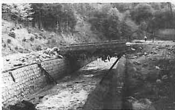
h) - Canal cu secțiunea cvasidreptunghiulară pe torentul Păltiniș - Bâsca R. - B.H. Buzău, la care s-a realizat debitul maxim din proiect (se văd resturile vegetale sub podeț rămase de la viiturile din lunile iunie-iulie 1991) care au distrus barajele filtrante din amonte, dar nu și canalul - 1992)
