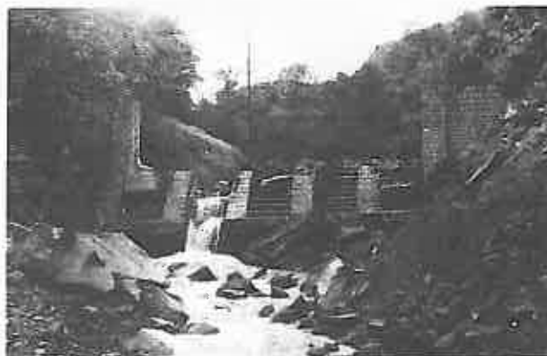
d) - Baraj "filtrant" din grinzi de beton armat dispuse în plan înclinat, paralel cu paramentul aval al contraforților în care sunt încastrate, rupt de viiturile excepționale din lunile iunie-iulie 1991 (8M4) care au scos din funcțiune toate barajele de acest tip de pe vale (V. Păltiniș - Bâsca R. - B.H. Buzău - 1992)
