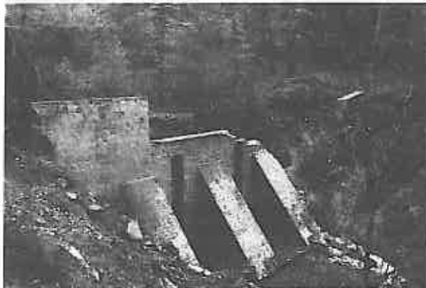
c) - Baraj din păci nearmate pe "contraforți - cu înălțime redusă" și fante verticale mari(8M3) rupt de viiturile torențiale din iunie-iulie 1991 care au declanșat și alunecarea de pe malul stâng al Văii Giurea Mare - B.H. Buzău - 1992
