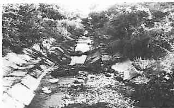
i) - Canal cu dublu profil trapezoidal din plăci de beton turnate pe taluz degradat (rupt). Sectorul aval (V. Pângărași - B.H. Bistrița) - 1993
