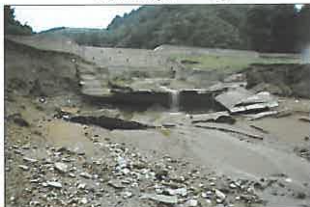
Foto 1. O.S. Topolnița - Perimetru de ameliorare Bremena, radier parțial distrus.
