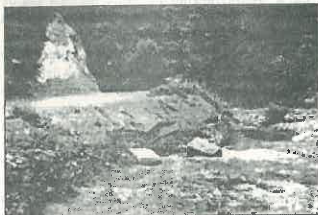
Fig. 4. Completări cu gabioane noi (epiuri) după viitură. Drum forestier Păscoaia. (Completations with new gabions after high floods. Forest road Păscoaia). Foto: Ivănuș Puiu - 1978.
