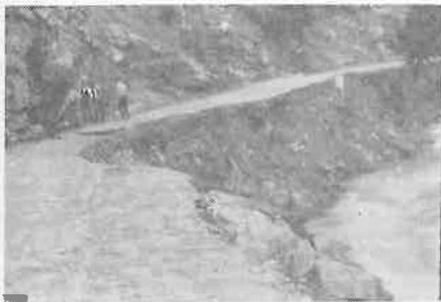
Fig. 3. Pagube cauzate drumului forestier de către inundația din anul 1969.
