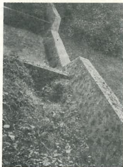
Fig. 6. Piesa 3.M.1.0. Se observă efectul eroziunii produse în spatele zidurilor de conducere de apele care au deversat peste întreaga lucrare. Pe aripile pragului și pe zidurile de conducere s-au depus materiale o dată cu scăderea nivelului apelor de viitură.
