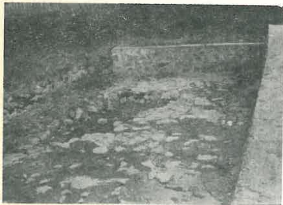
Fig. 1. Degradarea radierului. Se observă și degradări apărute la pragul deversorului.
