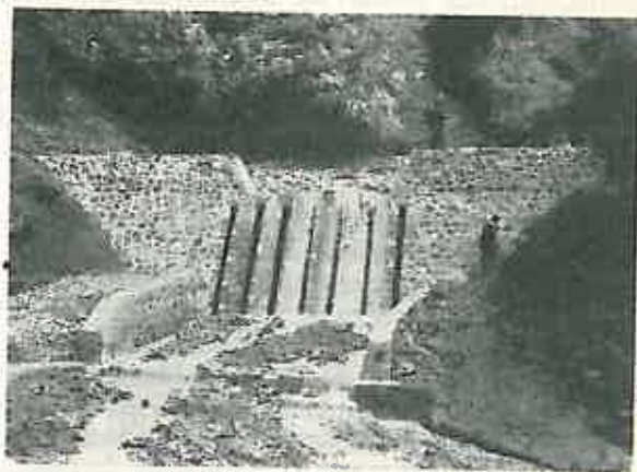
Fig. 2. Baraj cu fundație evazată-filtrant, colmatat de o viitură în anul 1970 (Bazinul Oanfu Bistrița).Foto : R. Gaspar.
