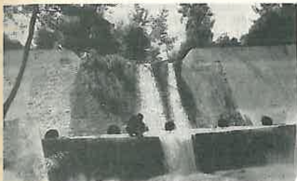
Fig. 3. Baraj cu deversorul parțial blocat (8. VII. 1970 Retevoești-Argeș. Foto: R. Gaspar.
