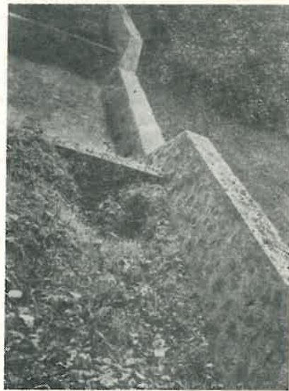
Fig. 6. Piesa 3.M.1.0. Se observă efectul eroziunii produse în spatele zidurilor de conducere de apele care au deversat peste întreaga lucrare. Pe aripile pragului și pe zidurile de conducere s-au depus materiale o dată cu scăderea nivelului apelor de viitură.
