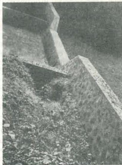
Fig. 6. Piesa 3.M.1.0. Se observă efectul eroziunii produse în spatele zidurilor de conducere de apele care au deversat peste întreaga lucrare. Pe aripile pragului și pe zidurile de conducere s-au depus materiale o dată cu scăderea nivelului apelor de viitură.
