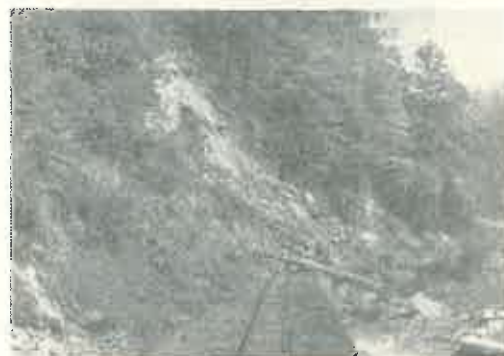
Fig. 1. Desprinderi de blocuri la km 4,7.
