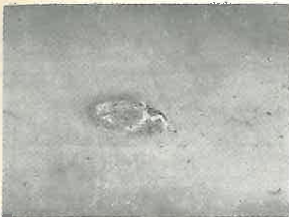
Fig. 6. Formație de groapă în mixtură asfaltică.
