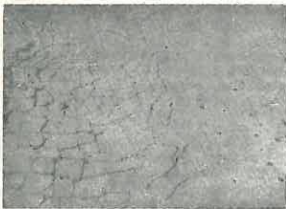
Fig. 4. Aspect al îmbrăcăminții cu fisuri sub formă de faianțări.
