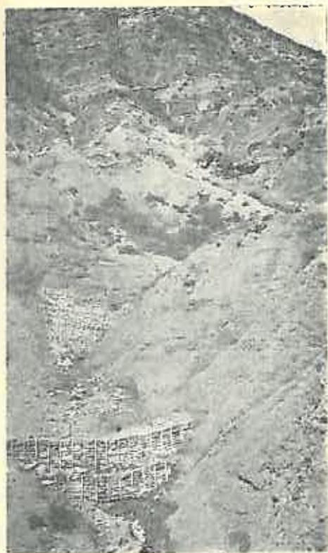
Fig. k. Baraje mici în piatră uscată armată. Se vede dispozitivul în trepte în basinul unui torent aproape complet lipsit de vegetație. Seria Marcoux (Basses-Alpes) 1935.
