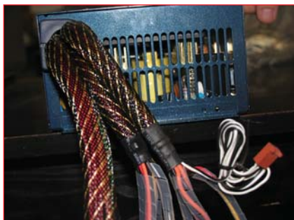
Mănunchiurile de cabluri sunt protejate suplimentar cu o plasă de plastic
