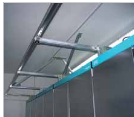
Toată aparatura este protejată împotriva seismelor cu mecanisme ingenioase.
